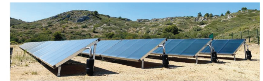
Exemple Centrale solaire thermique Narbonne : 3 200 m2 de panneaux solaires qui alimentent en eau chaude sanitaire 900 foyers, huit établissements scolaires et des bâtiments publics.
